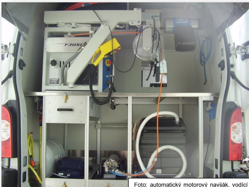
Foto: automatický motorový naviják, vodící kladka, čidlo měření odvinutého kabelu, jeřábek s hákem pro spuštění kamery do šachty
