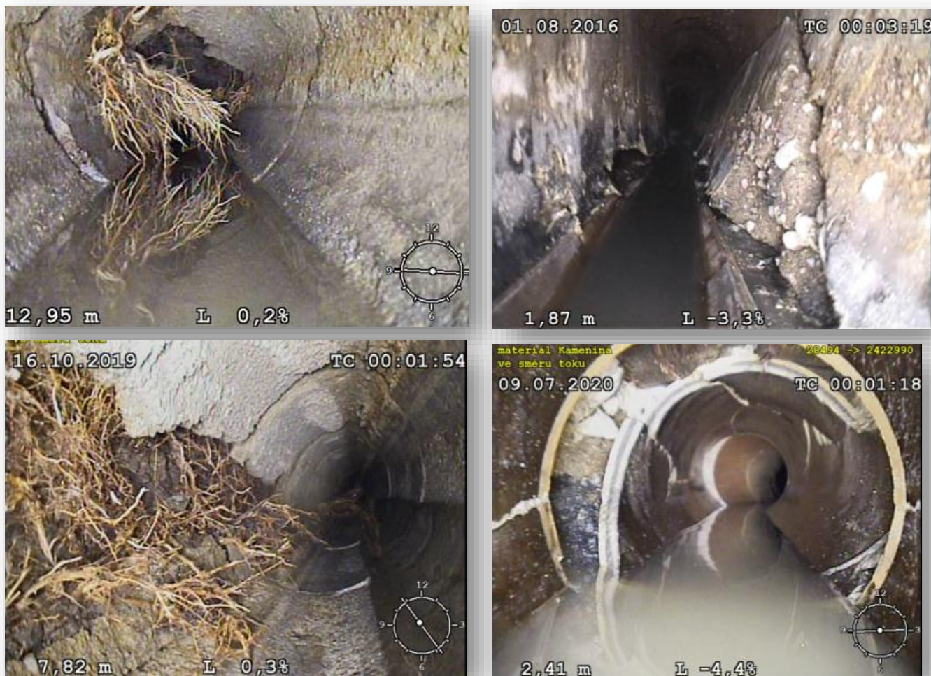
Foto: příklady poškození stoky – prorostlé kořeny, praskliny, chybějící část stěn, dna, deformace, tvořící se kaverny, netěsnosti, koroze a degradace
